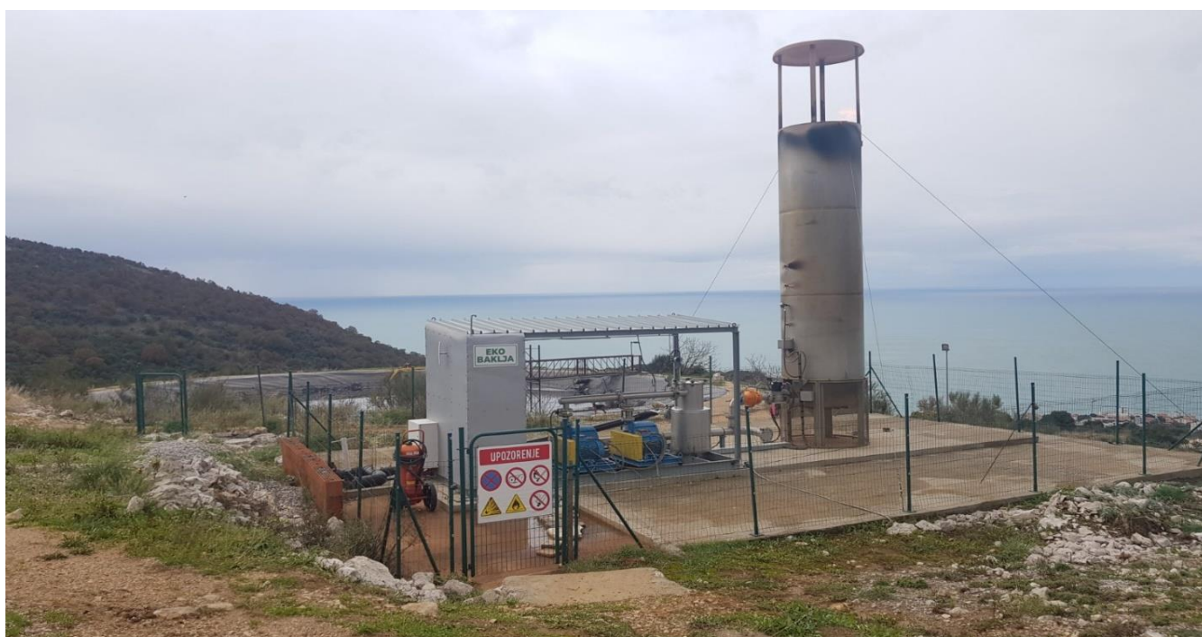
Slika 3: Postrojenje za sagorijevanje deponijskog gasa na deponiji „Možura“
